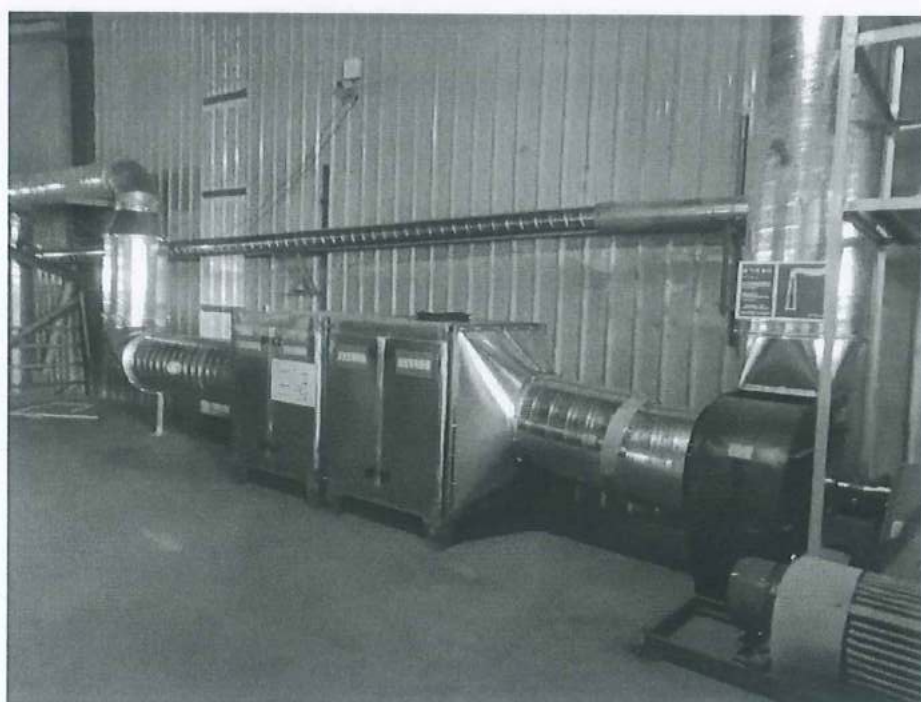
图 4.2 挤出有机废气治理设施图
