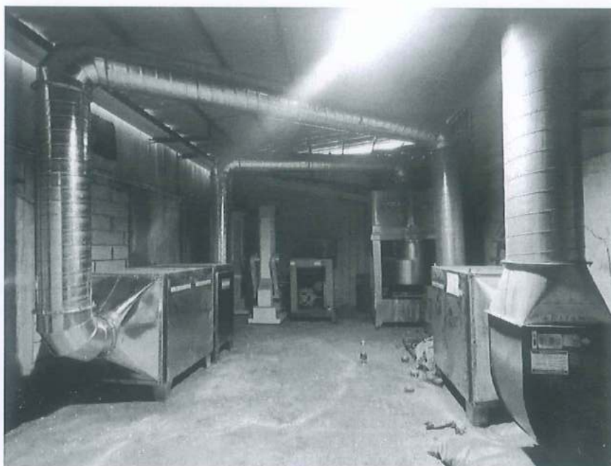
图 4.5 固化有机废气治理设施图
