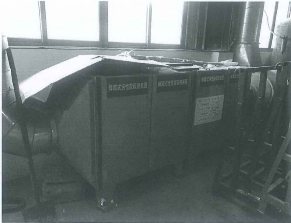
图 4.2 中空玻璃、夹胶玻璃工序有机废气治理设施图
